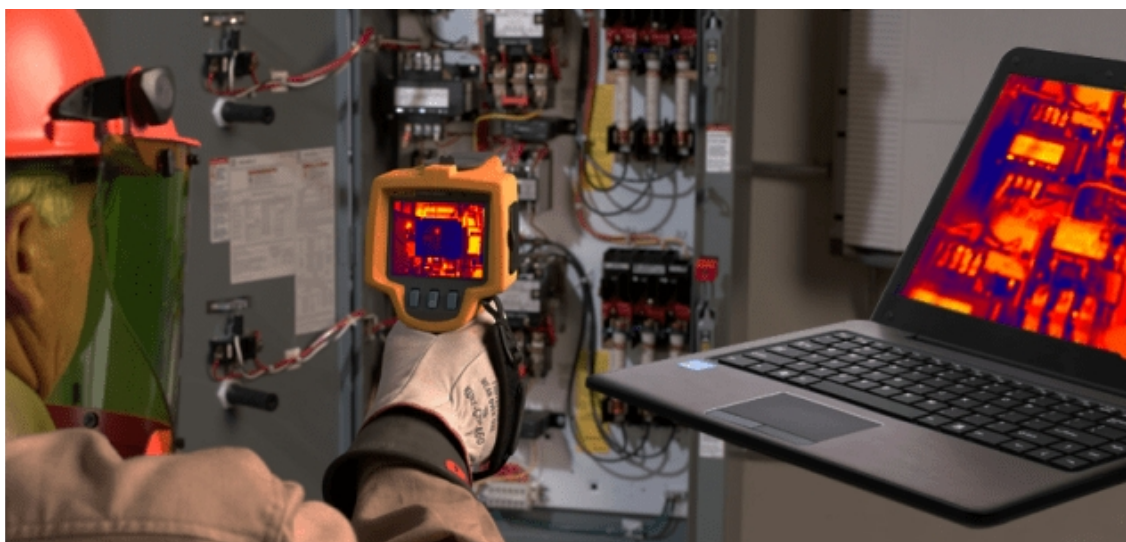
Рисунок 20. Пример проведения тепловизионного контроля электрошкафа
