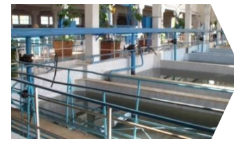
МУП «УПРАВЛЕНИЕ «ВОДОКАНАЛ»
